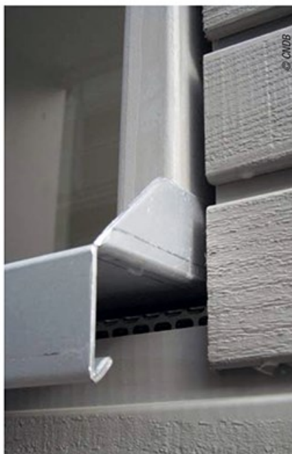
Ne pas oublier la grille anti-rongeur sous la fenêtre. Garder une distance appropriée entre les lames et l'encadrement de fenêtre pour que l'eau n'y stagne pas.
