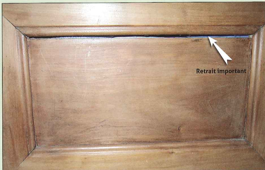
27 Défaut lié à l'orientation du fil du panneau : à l'horizontale
